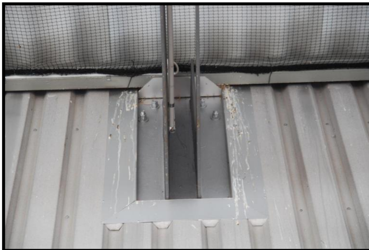
Nicht verdeckte Spalten (Vogelschutznetz) in der Dachkonstruktion
