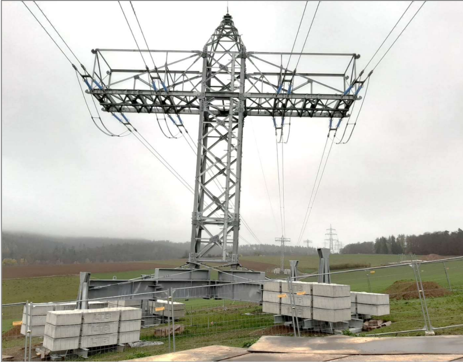
Abbildung 4 Beispiel für einen provisorischen Masten entlang der A120 (Foto: JENA-GEOS)
