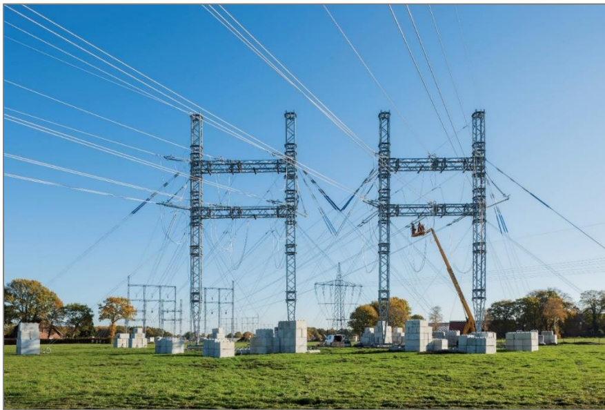
Abbildung 11: Freileitungsprovisorium für zwei 380-kV-Stromkreise
