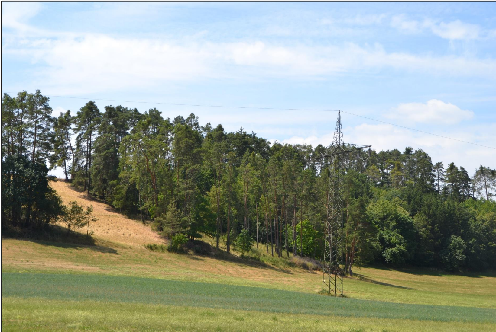
Abbildung 27: Mast Nr. 364 (seitlich)
