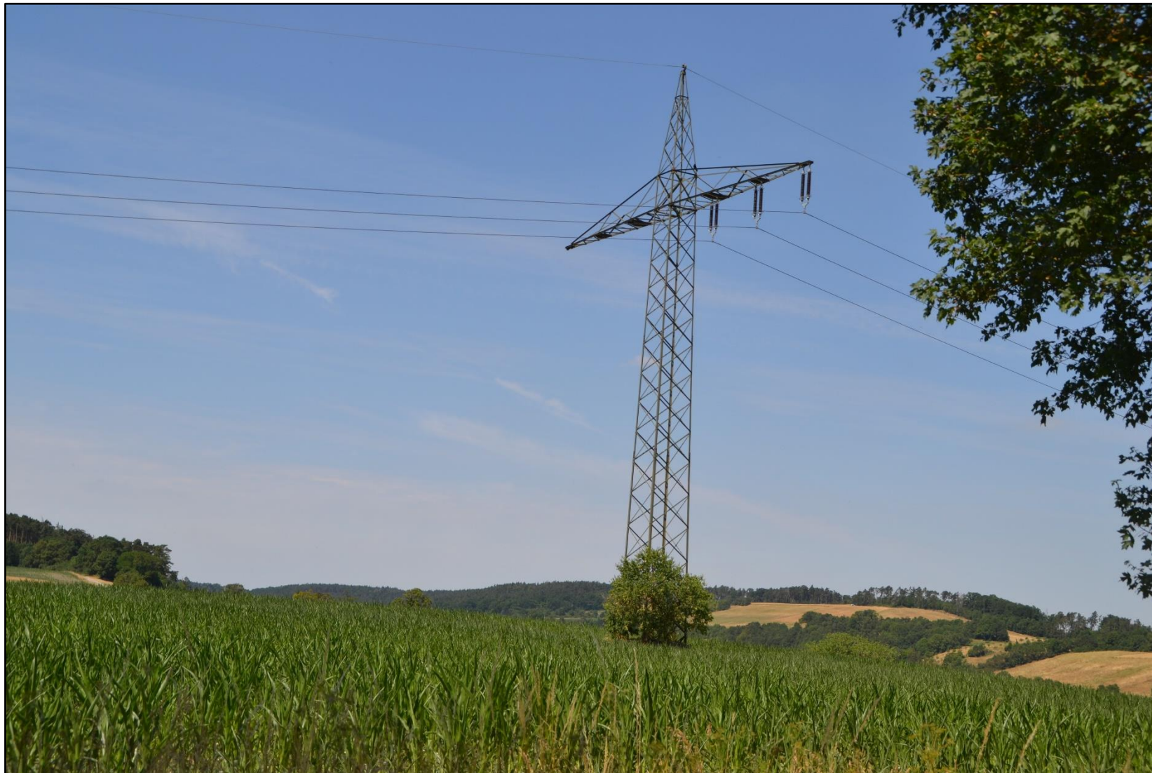
Abbildung 24: Mast Nr. 361 (seitlich)
