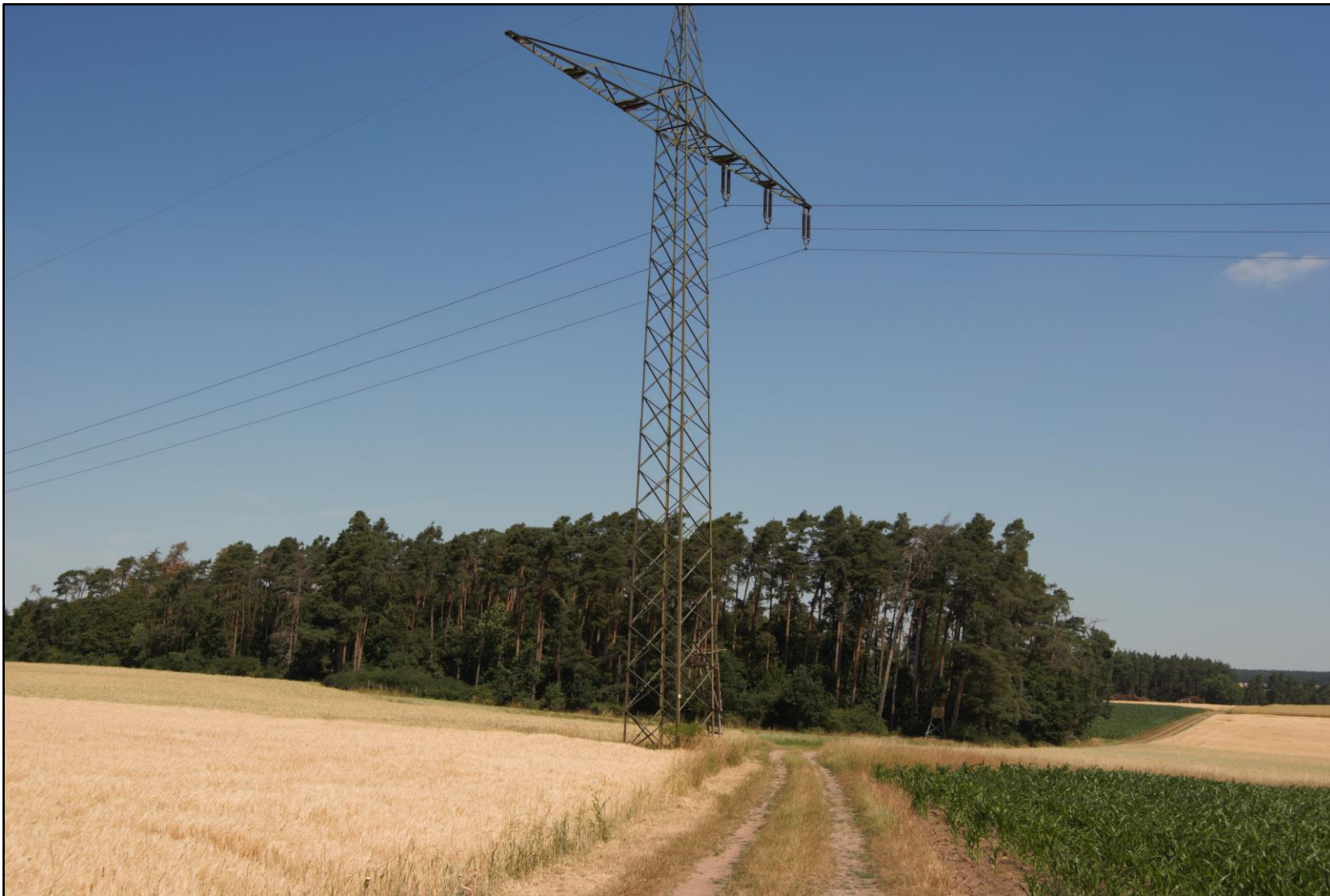
Abbildung 18: Mast Nr. 355 (seitlich)
