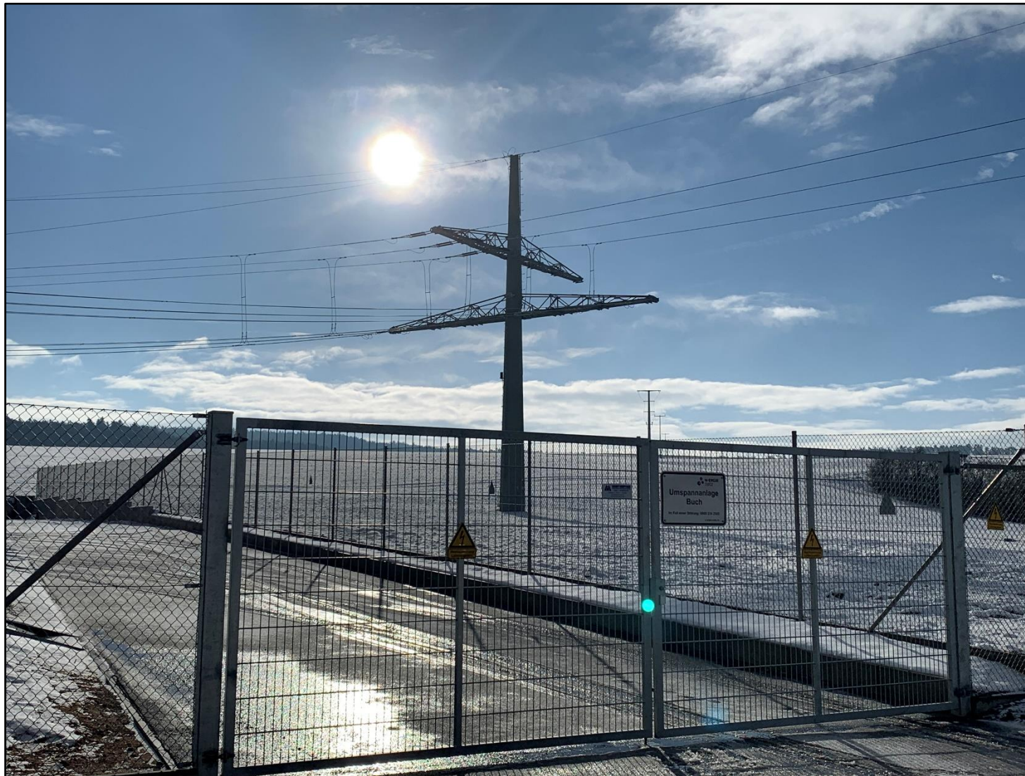
Abbildung 39: Mast Nr. 376 und UW Buch (Ersatzneubau nicht Teil des Vorhabens – nur Leiterseilwechsel)
