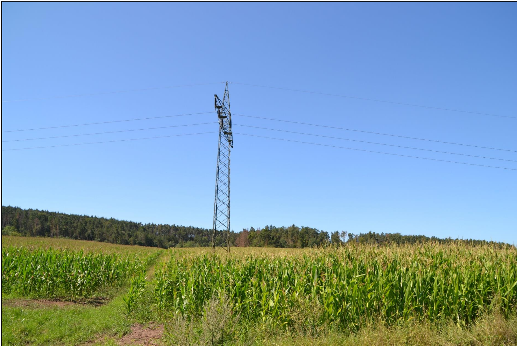
Abbildung 45: Mast Nr. 382 (seitlich)
