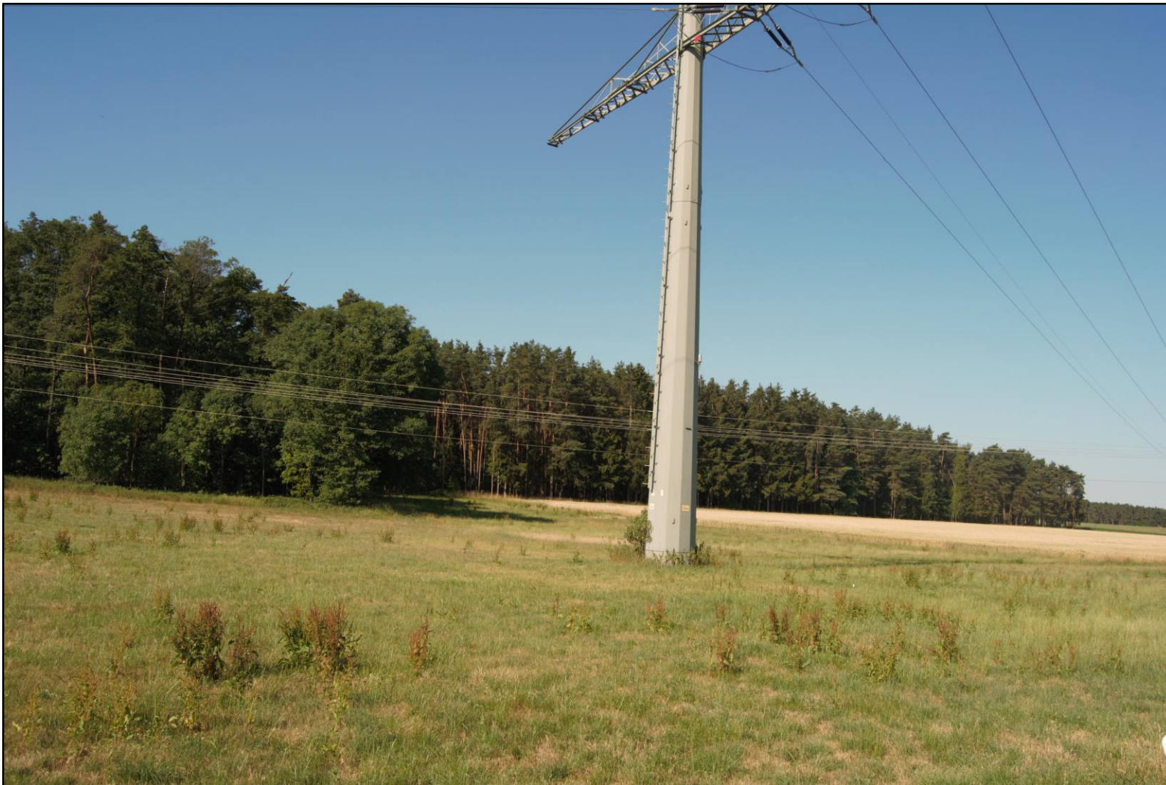
Abbildung 7: Mast Nr. 344 (seitlich)
