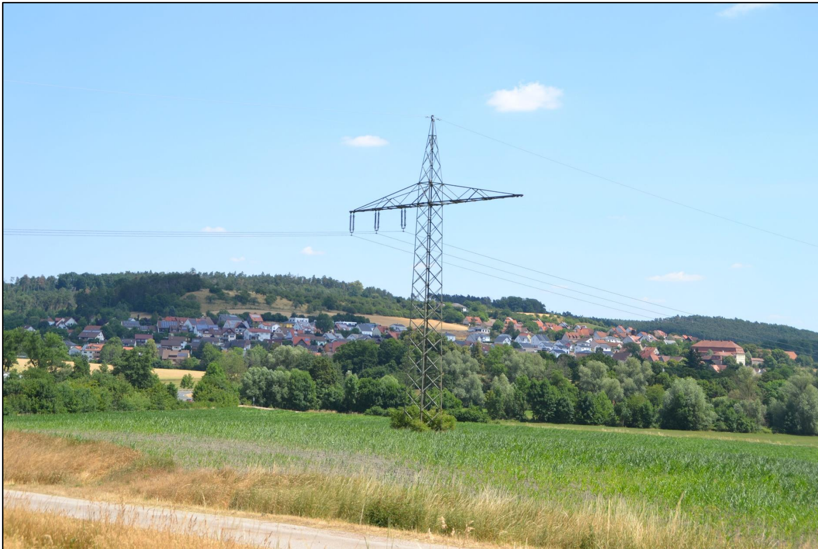
Abbildung 32: Mast Nr. 369 (seitlich)
